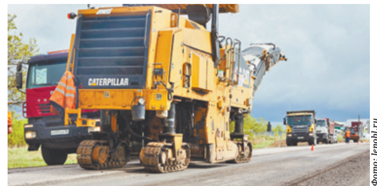
Дорожные работы на региональной трассе Лодейное Поле — Тихвин — Будогощь в Тихвинском районе
